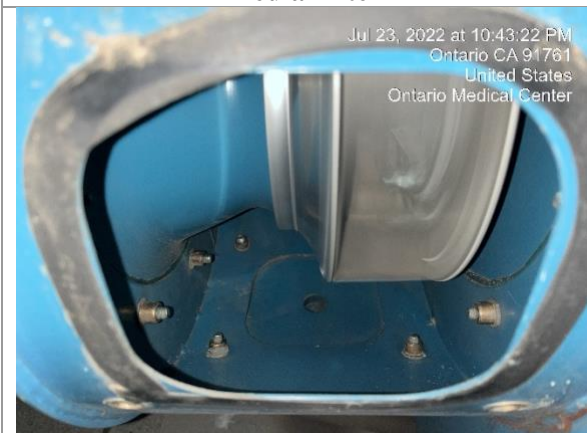
Before Exhaust Fan
