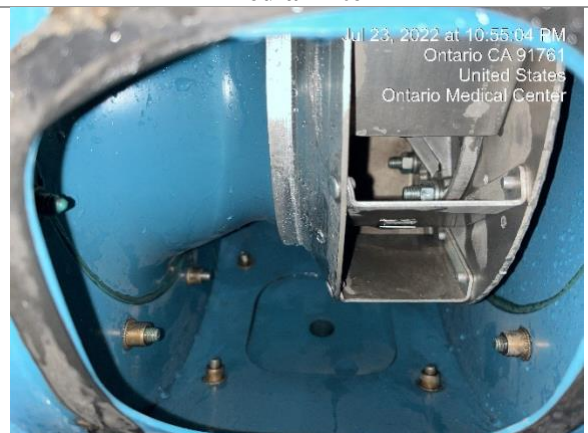
After Exhaust Fan
