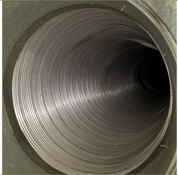
--After-- Main Duct
