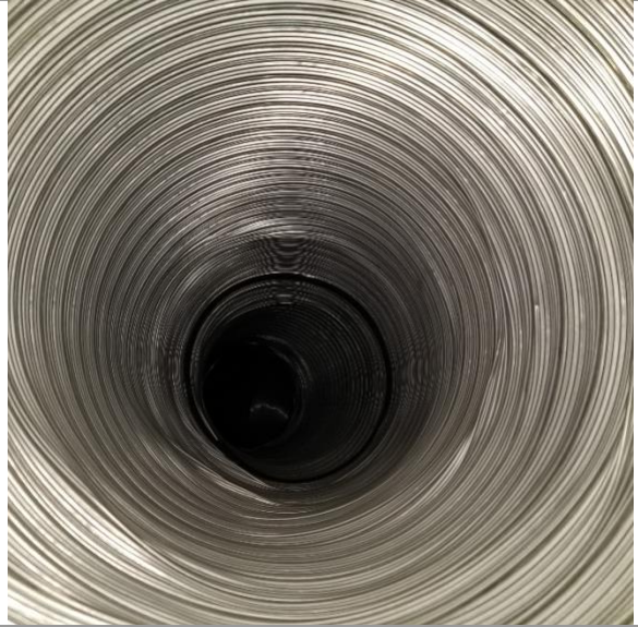
--After-- Main Duct
