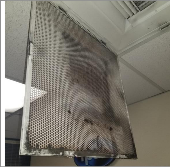
--Before-- Screens dirty
